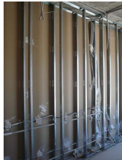
Detalle ESV-03.b.V3. Instalación incorrecta de las instalaciones. Deben evitarse los contactos rígidos entre las hojas de las placas
