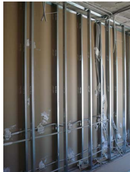
Detalle ESV-03.a.V3. Instalación incorrecta de las instalaciones. Deben evitarse los contactos rígidos entre las hojas de las placas
