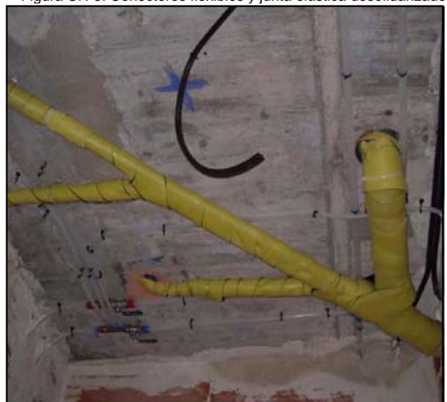
Figura CH-7. Aislamiento de pulpo de desagüe
