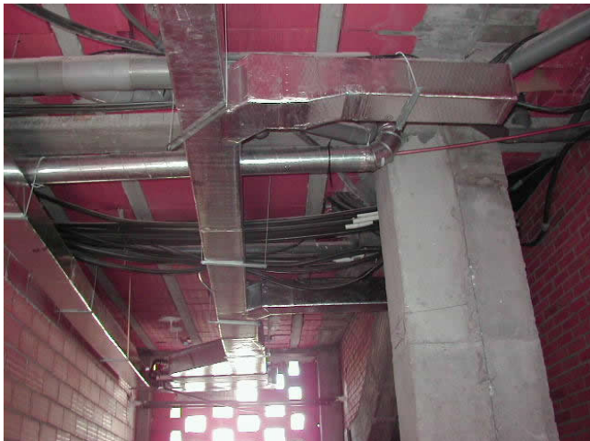
Figura CLI-03. Ejemplo de conductos de climatización
