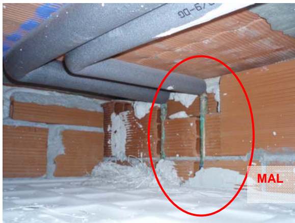
Figura CH-3. Detalle de tuberías empotradas en la partición sin retacar en una partición sin revestir en el espacio que queda por encima del falso techo.
